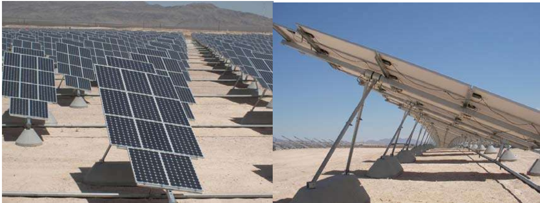
Figure 20 Photographies de la ferme solaire de 14MW située sur la base aérienne Nellis dans le Nevada.
